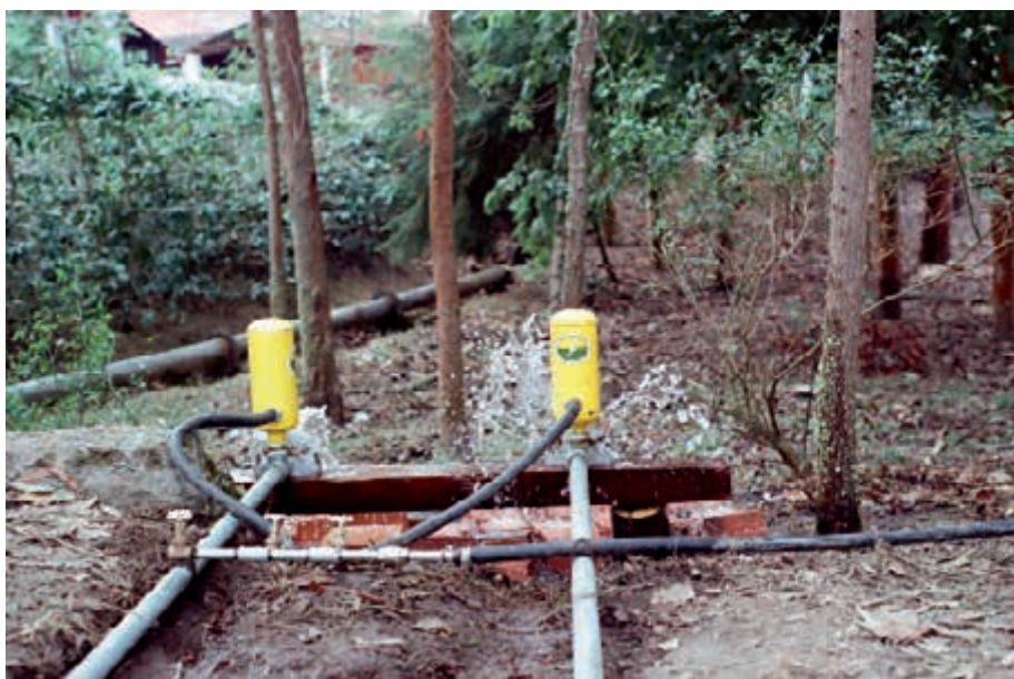
Microacueducto rural con arietes GAVIOTAS
